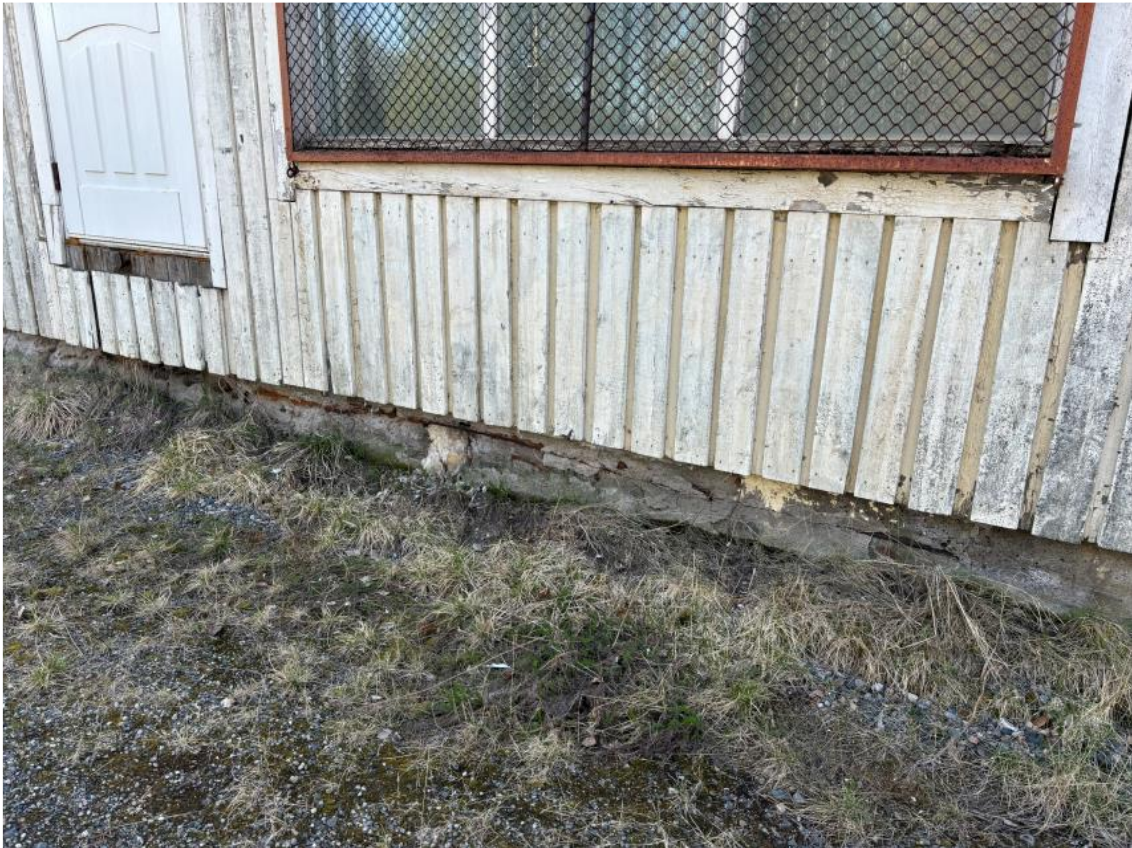
Kuva 18. Ote kuntoarvion s.6 valokuvadokumentaatiosta, jonka kuvatekstissä arvioon laatija toteaa "Ikkunoiden kunto heikko, pellitykset puuttuvat. Rännit ja syöksytorvet puuttuvat. Perustus on pettänyt." Kuva J. Vanhapiha 2024.
