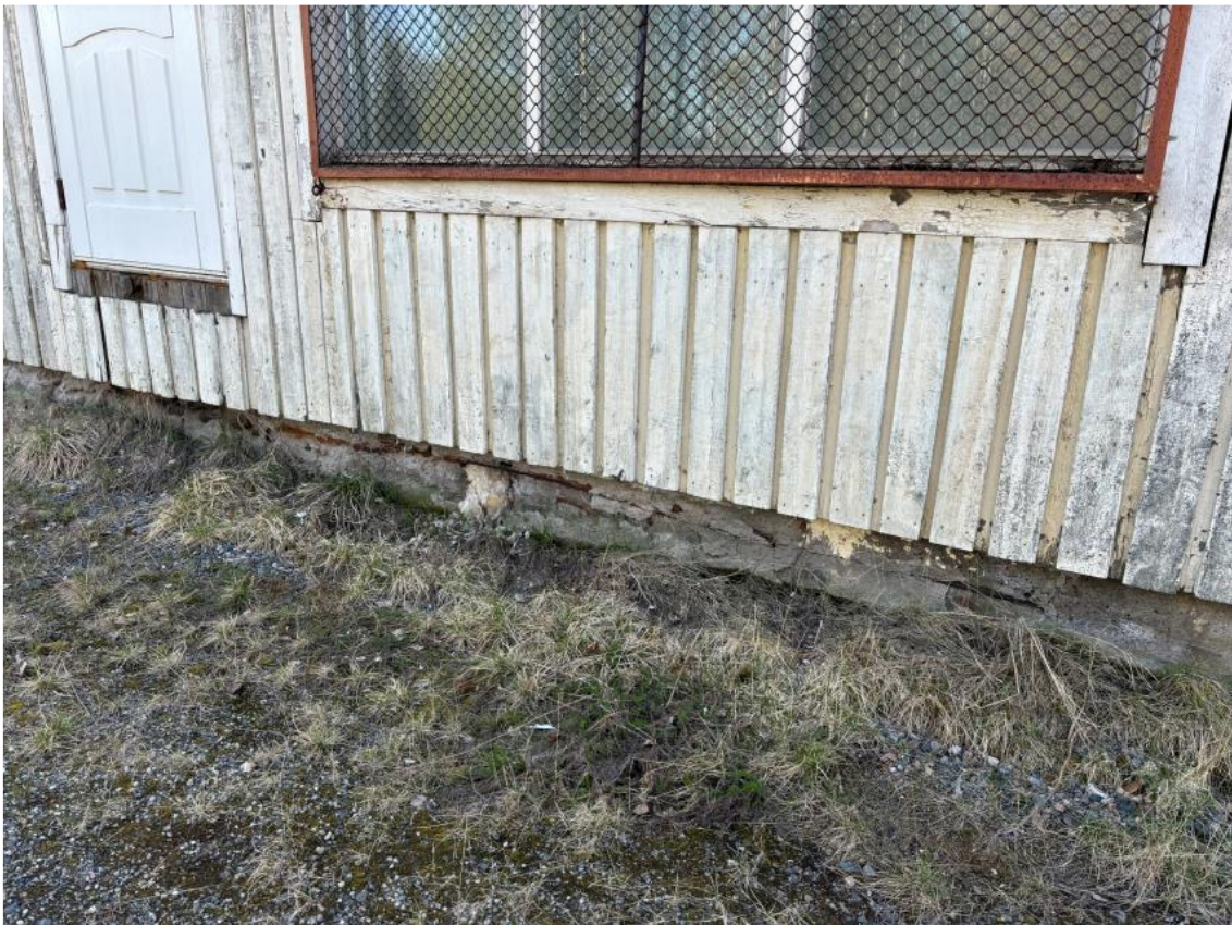
Kuva 18. Ote kuntoarvion s.6 valokuvadokumentaatiosta, jonka kuvatekstissä arvioon laatija toteaa "Ikkunoiden kunto heikko, pellitykset puuttuvat. Rännit ja syöksytorvet puuttuvat. Perustus on pettänyt." Kuva J. Vanhapiha 2024.
